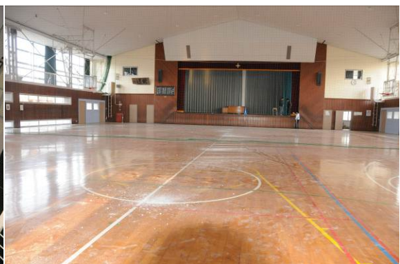
写真 16 散乱により床が白く汚れる
