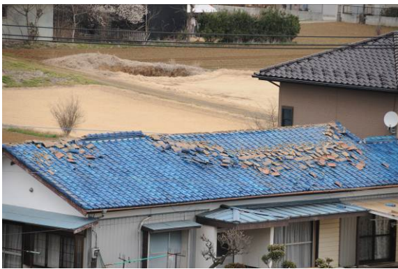
写真 19 学校周辺の家屋の被害状況 (その 1)
