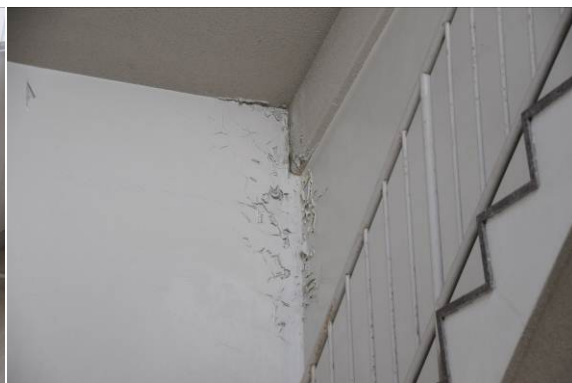
写真6 天井の一部が崩れる
