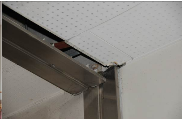
写真 12 天井付近の継ぎ目
