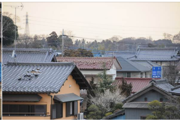
写真 20 学校周辺の家屋の被害状況 (その 2)
