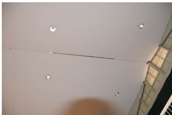
写真 15 天井の継ぎ目の一部が崩落
