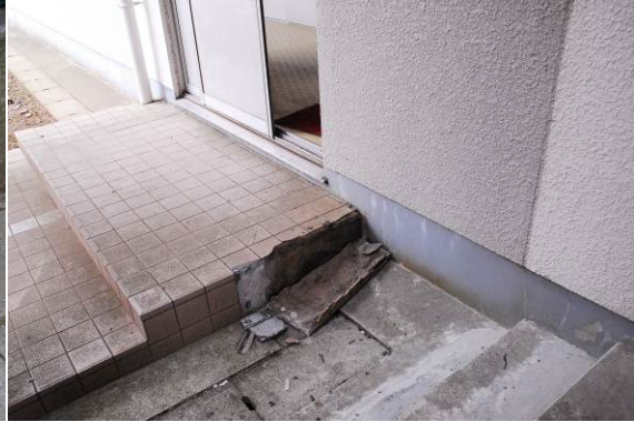
写真 18 タイルの一部が崩壊
