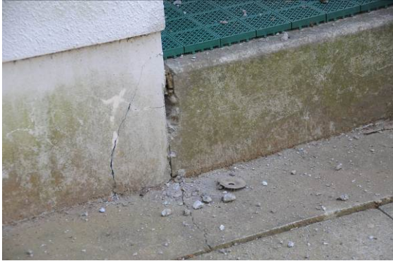
写真 17 たたきの継ぎ目の一部が破損
