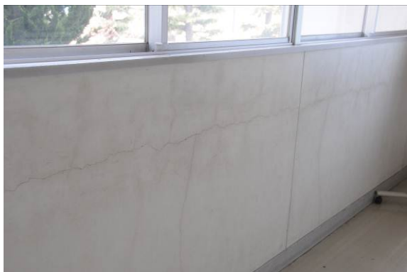
写真5 壁に生じたひび
